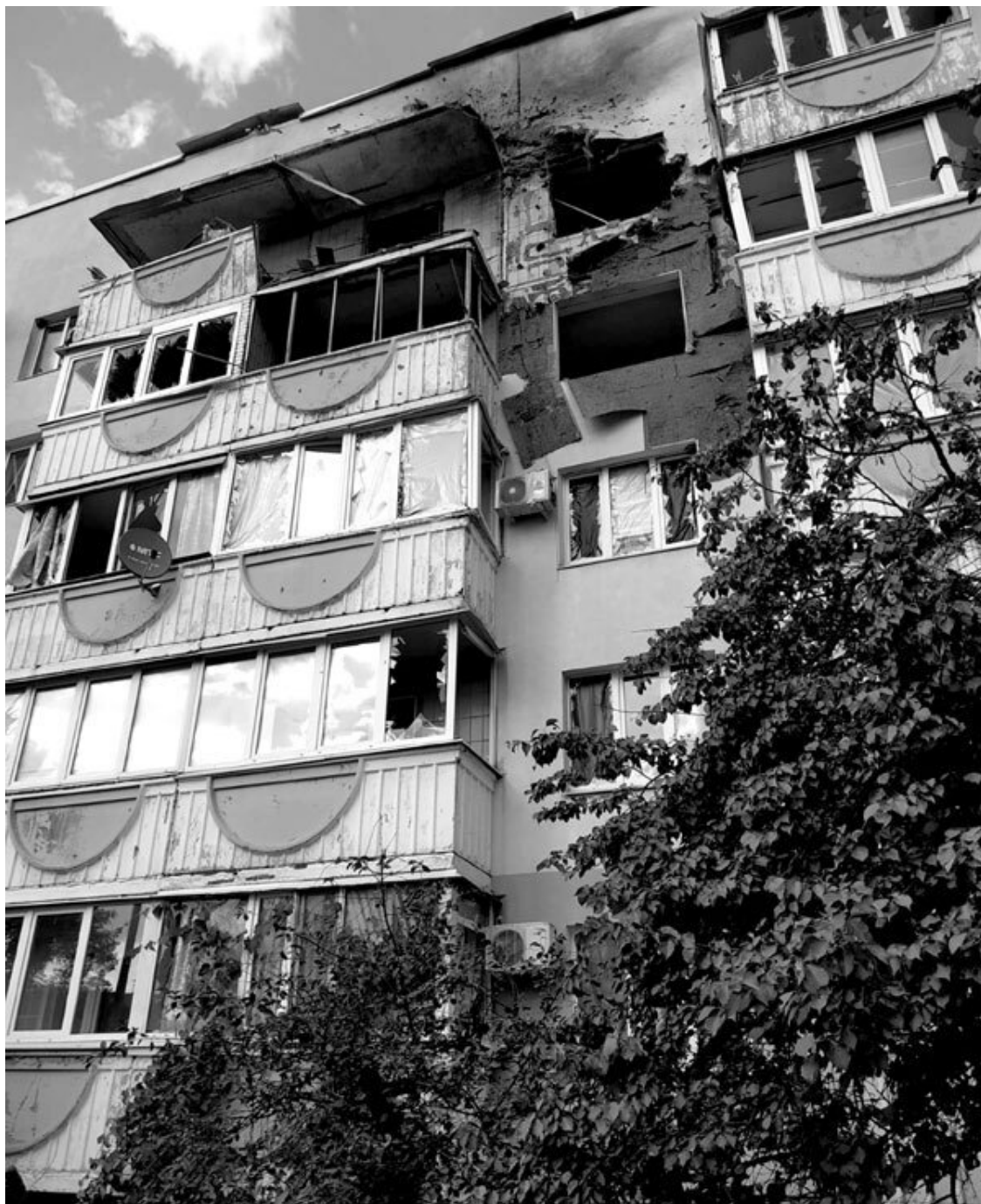
Шебекино. Дом после попадания и пожара
