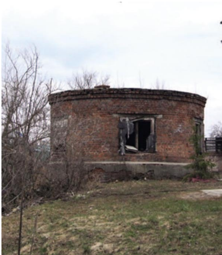
Рис. 9. Руины беседки-ротонды 2009 г. Верх ротонды перестроен
