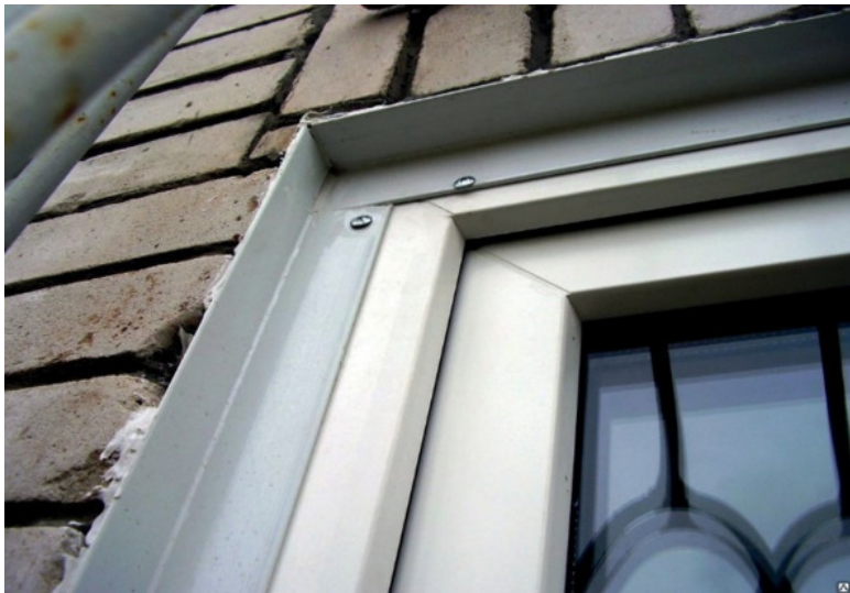
Рисунок 9. Фотография монтажного шва, в котором наружный слой выполнен из нащельника
