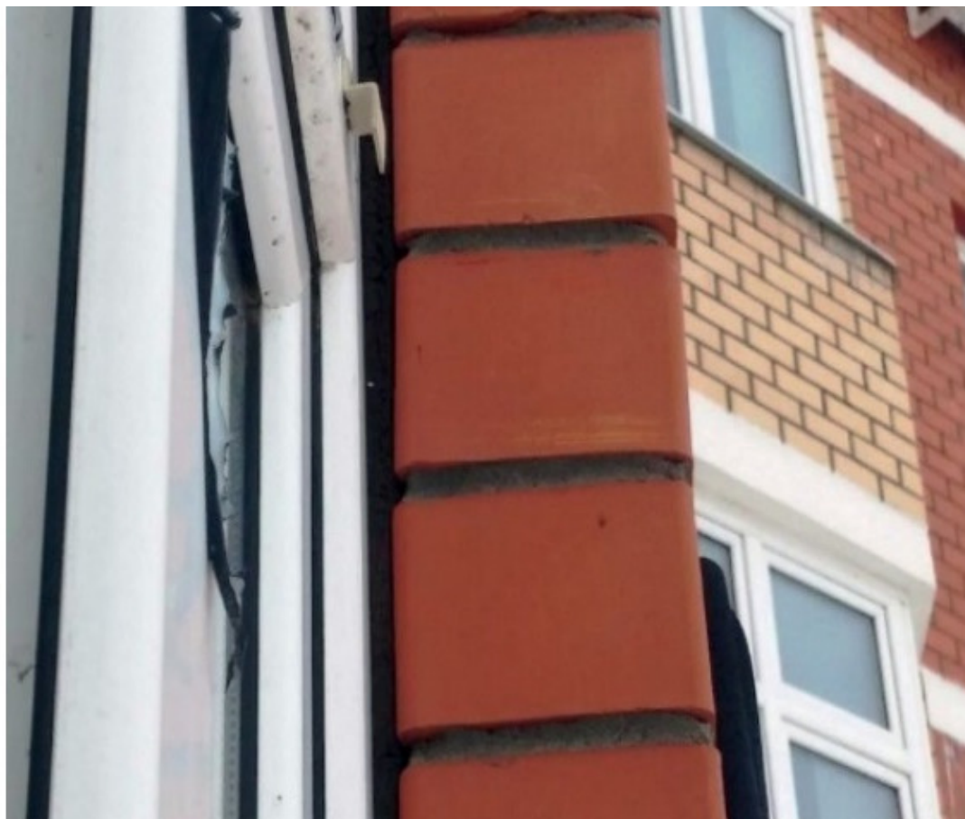
Рисунок 5. Внешний вид монтажного шва окна, на которое жаловался Клиент, до нанесения герметика Стиз А
