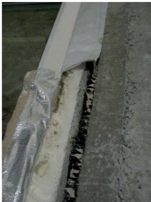
Рисунок 10. Внешний вид монтажного шва, при выполнении которого пена была закрыта изнутри пароизоляционной лентой. Пена неправильно полимеризовалась и не набрала своих свойств
