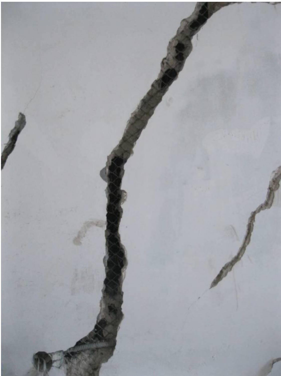
Следы пожара в трещинах стен бывшей библиотеки. Фото автора
