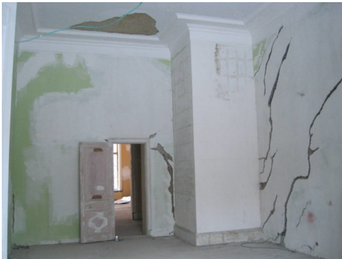
Трещины в стенах библиотеки. В глубине – бывшая «кружевная спальня». Фото автора
