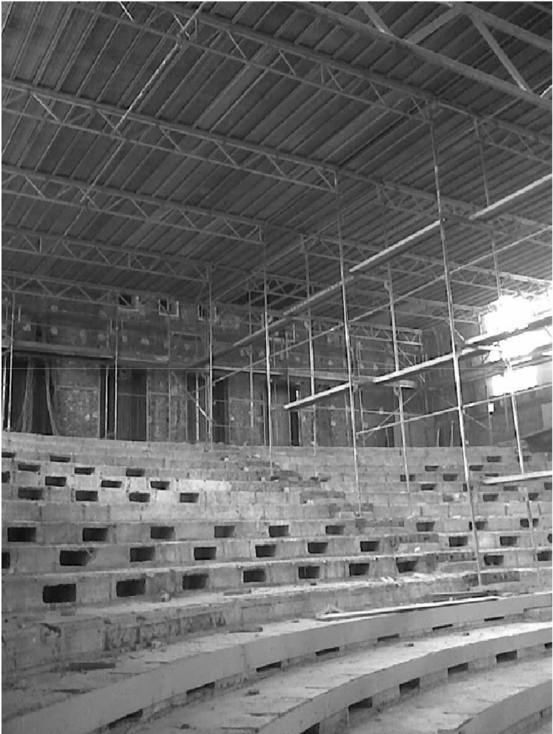
Der große Hörsaal mit dem Raumgerüst. Oben links sind die Datenkabel erkennbar.
