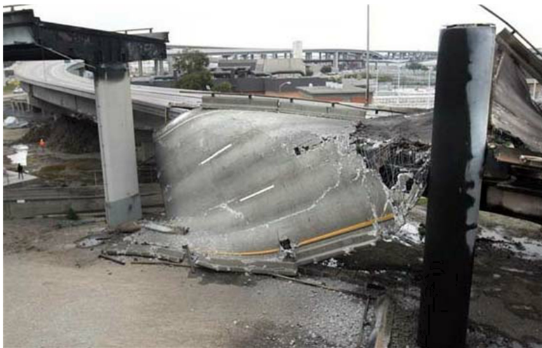
Рис. 2.4. Обрушение эстакады после землетрясения в Сан-Франциско
